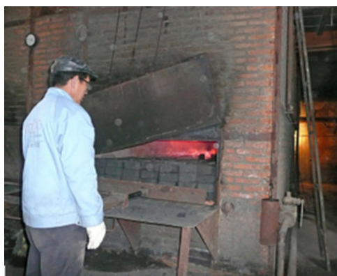
中国の低効率ボイラー
