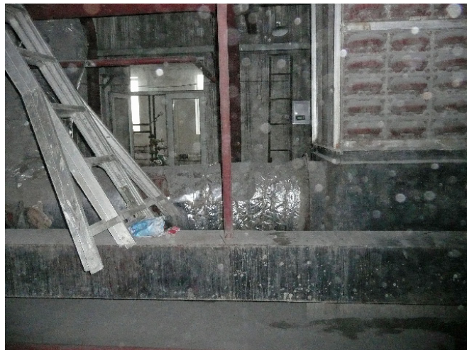
図 3.17 ボイラー裏配管の断熱
