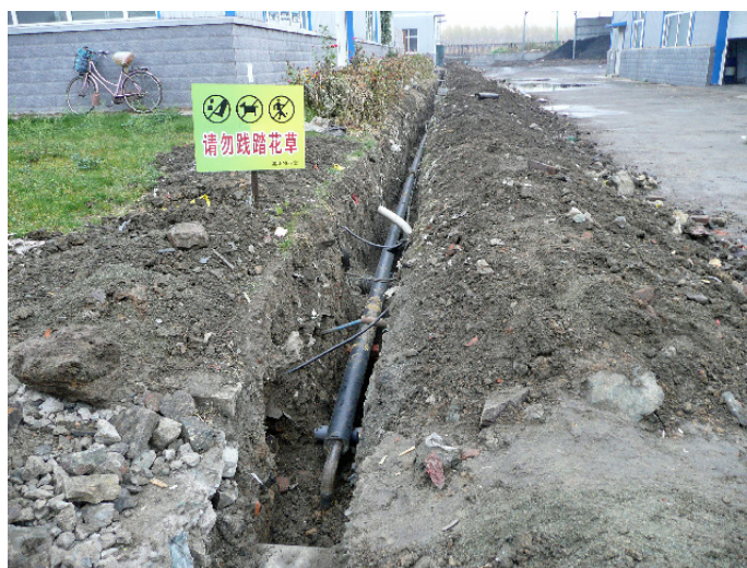
図 3.14 排熱で温めた温水を流すパイプライン
