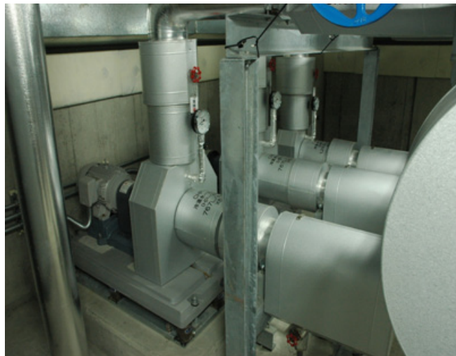
図 4.16 断熱と雨仕舞を施したポンプ
