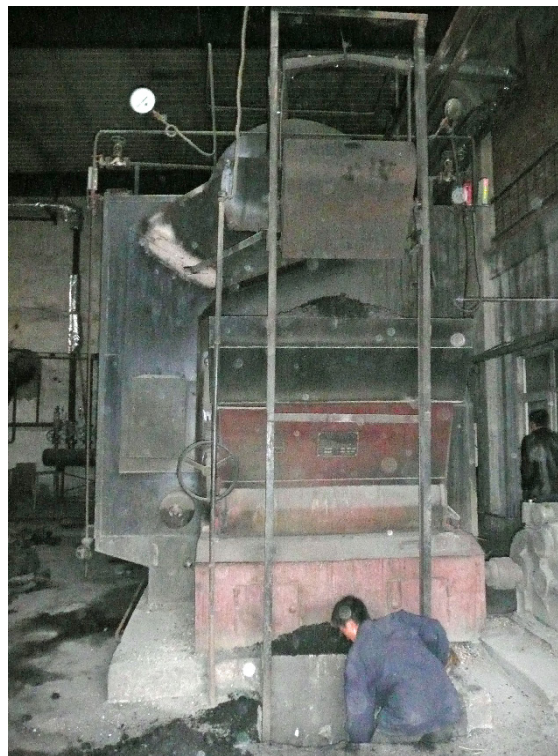
図 3.16 6t ボイラー
