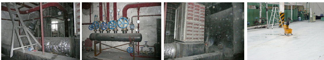
図 3.20 断熱強化や漏れ補修が必要な箇所
