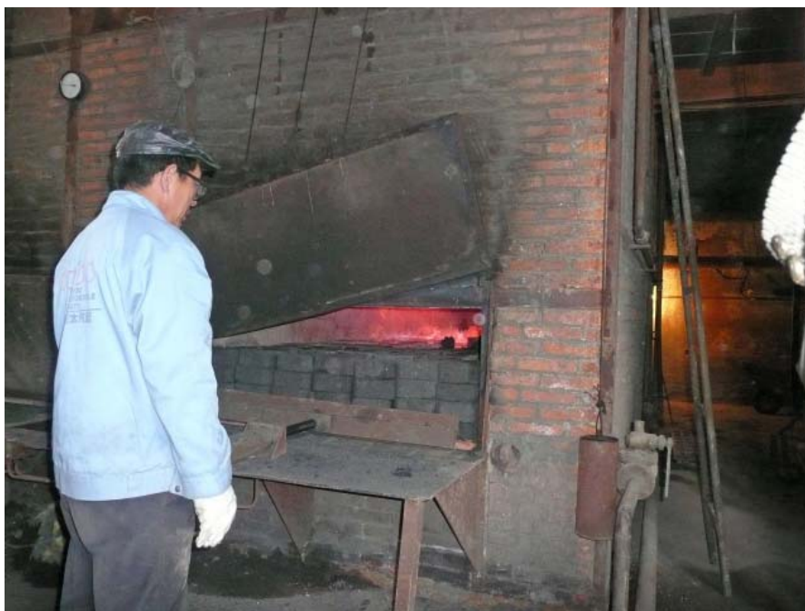
図 3-10 ボイラーの燃料供給口
