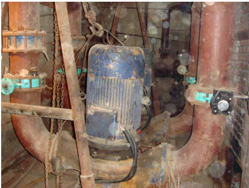
図 3-9 断熱不良の温水循環ポンプおよび配管（ボイラー背面）
