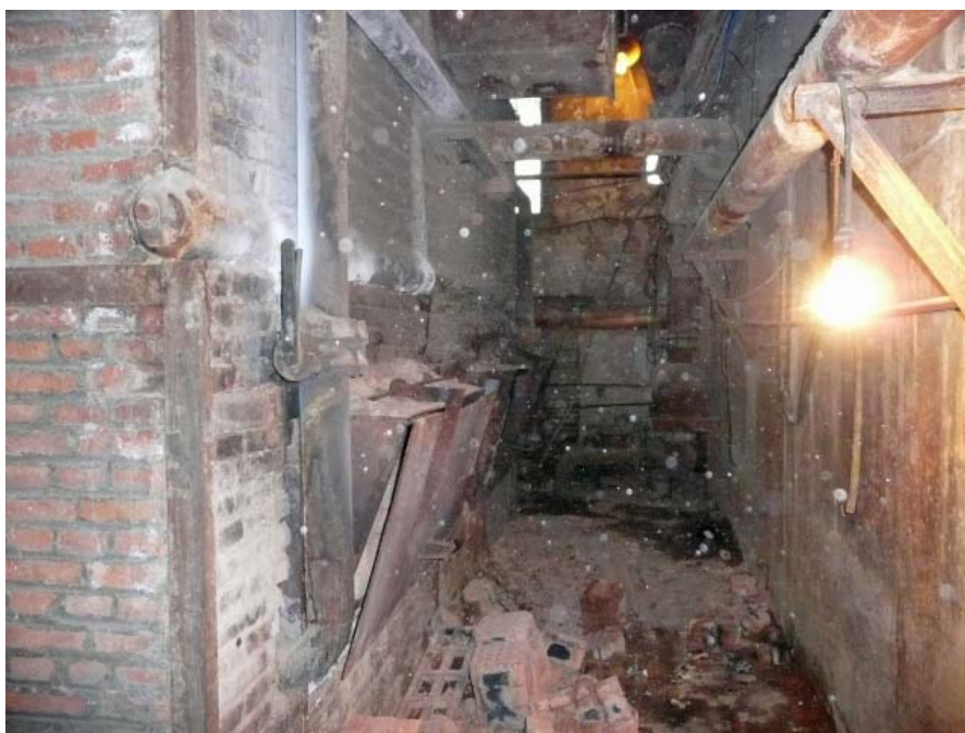
図 3-11 ボイラーの背面
