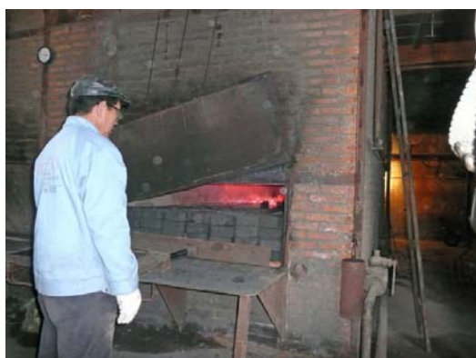
中国のボイラー
