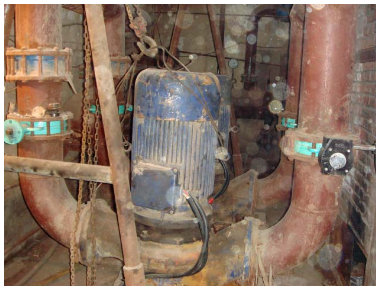
図 5-5 調査企業の断熱不良の温水循環ポンプおよび配管
